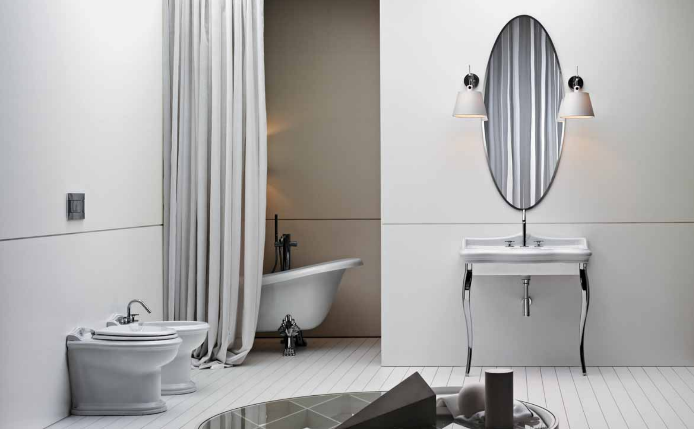
consolle Jubilaeum 91 su struttura in metallo cromato, vasca in crystaltech con piedini cromati, wc e bidet a terra filo muro, rubinetteria collezione LINEA. Specchio ellittico con molatura cm 115x55.
